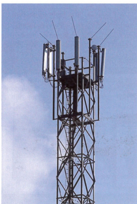
Abb. 2: Antennen als Grundlage der Kommunikation
