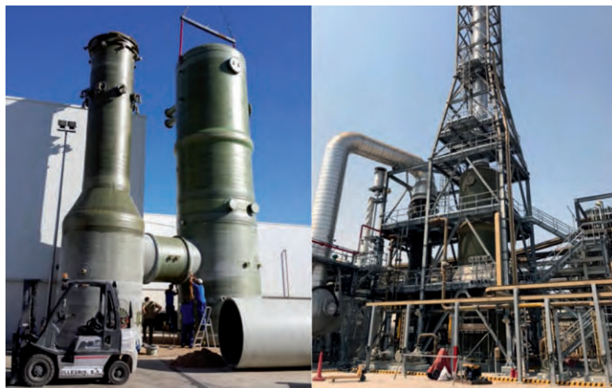
Abbildung 1: Quench und Scrubber (links) und installiertes System (Quelle: AOC/ Ollearis)
